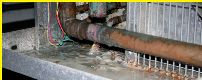
Bovenstaand: Een besmette condenswaterlekbak op een verdamper unit
